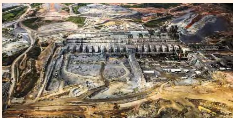
Figura 16. Usina Hidrelétrica de Belo Monte, PA.
