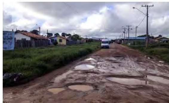
Figura 22. Acesso precário a conjunto residencial. (IBAM/PQGA, 2016).
