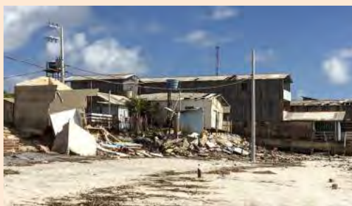
Figura 36. Casas construídas em alvenaria, já destruídas pela variação das marés. (IBAM/PQGA, 2016).
